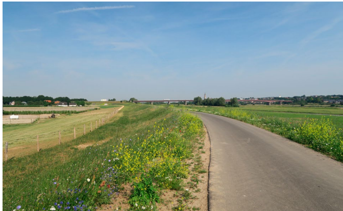
Afb. 2.52. Binnenberm met 1:10 talud en leeflaag. Berm is integraal onderdeel van aangrenzende kavel. Locatie foto: Marsdijk 27-31 Lienden
