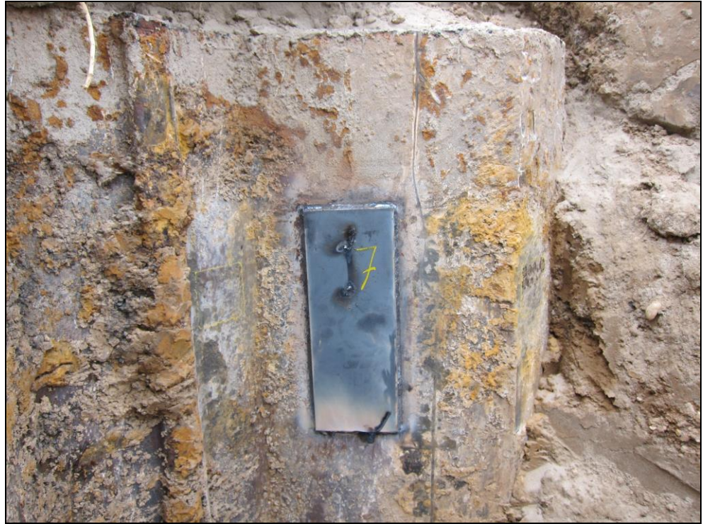
Foto 63: Herstelplaat genomen staalcoupon locatie 7.
