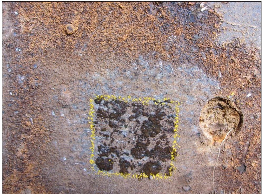
Foto 38: Gat op ca. -0,42 m t.o.v. bovenzijde damwand.
