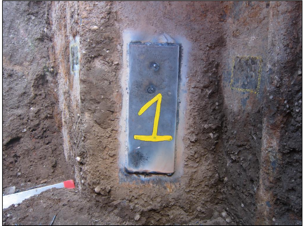
Foto 11: Herstelplaat genomen staalcoupon locatie 1.
