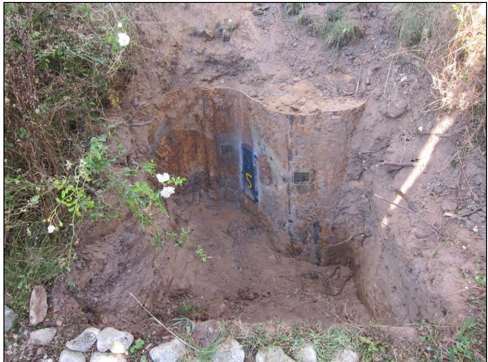
Foto 44: Herstelplaat genomen staalcoupon locatie 5.
