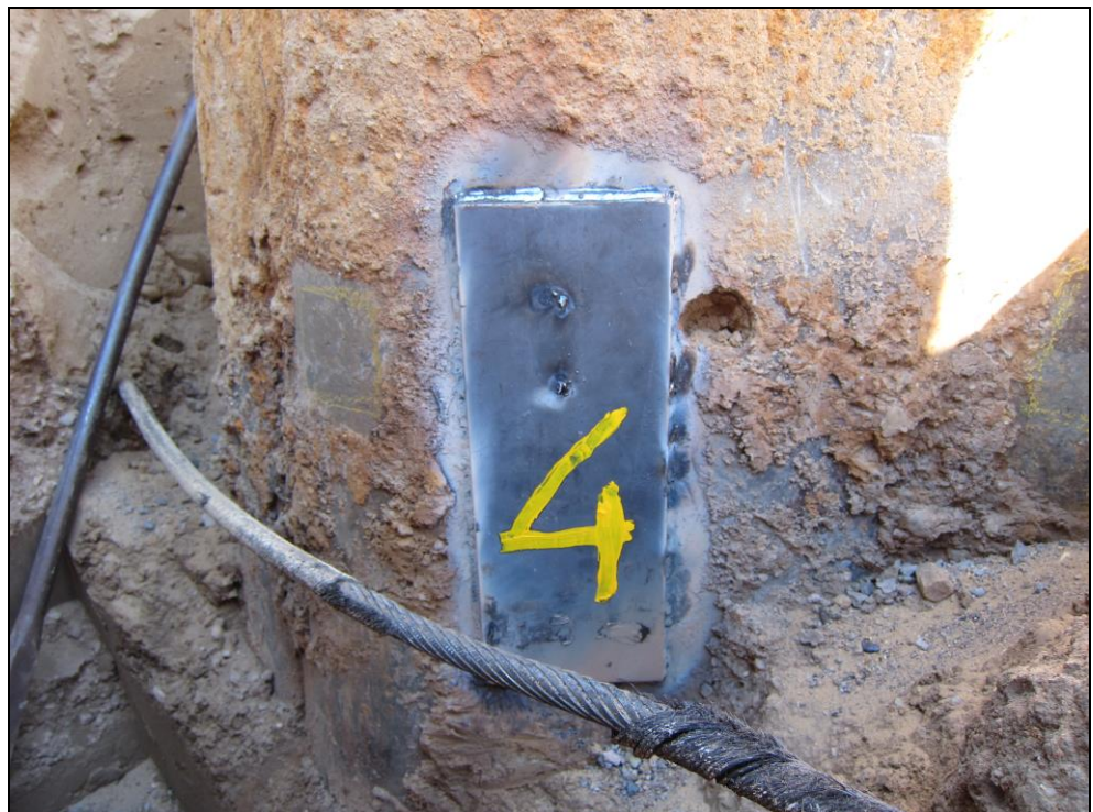
Foto 36: Herstelplaat genomen staalcoupon locatie 4.
