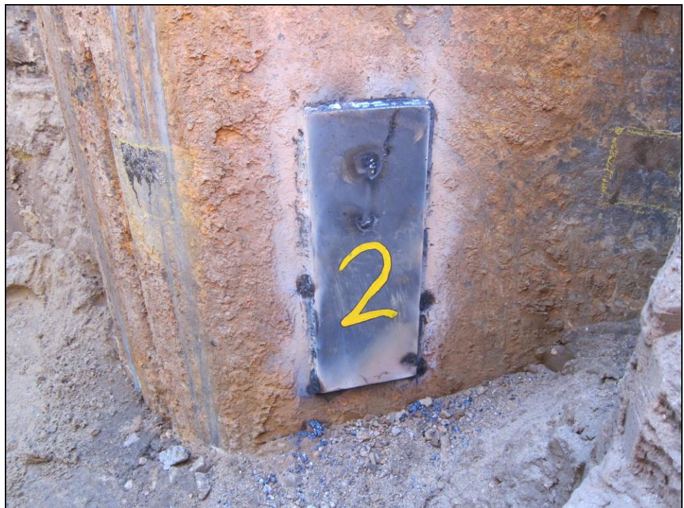
Foto 20: Herstelplaat genomen staalcoupon locatie 2.
