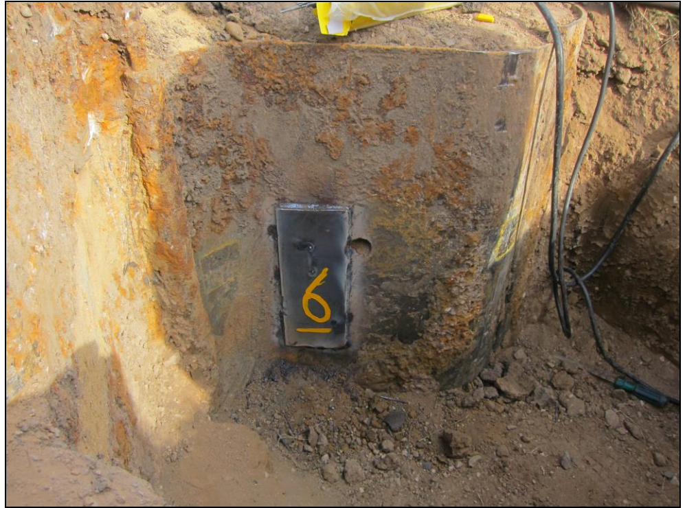
Foto 55: Herstelplaat genomen staalcoupon locatie 6.
