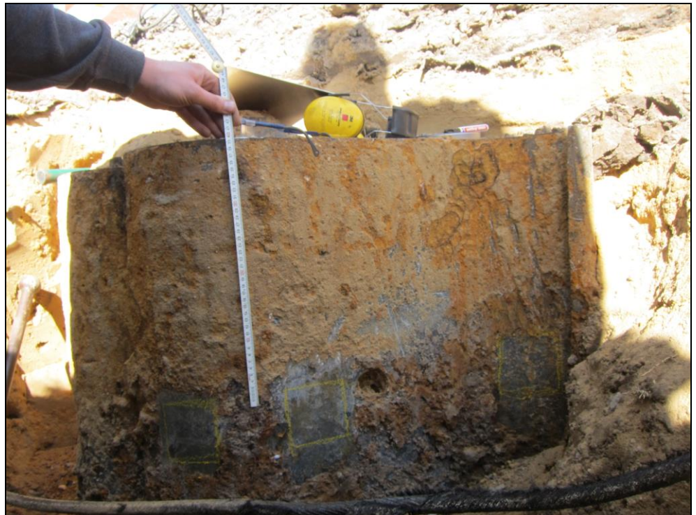
Foto 30: Locaties staaldiktemetingen locatie 4 incl. gat op ca. -0,40 m t.o.v. bovenzijde damwand.
